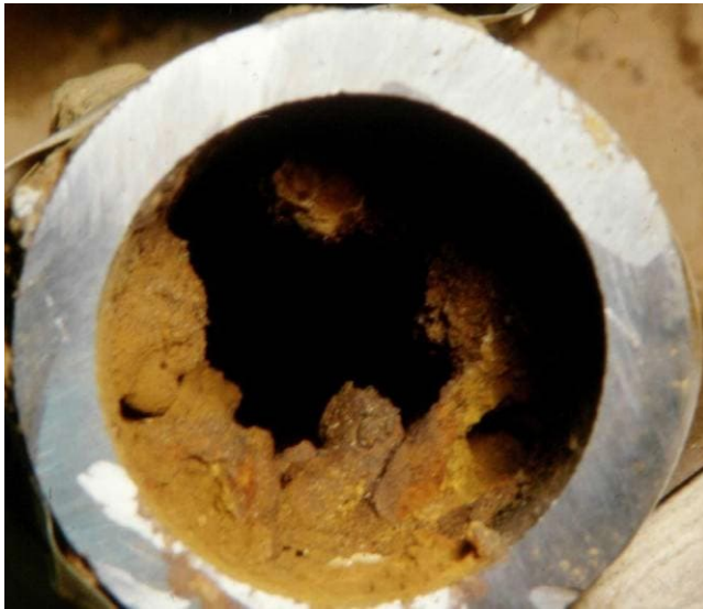
Kuva 15. Korroosion aiheuttamia syöpymiä valurautaputkessa.
